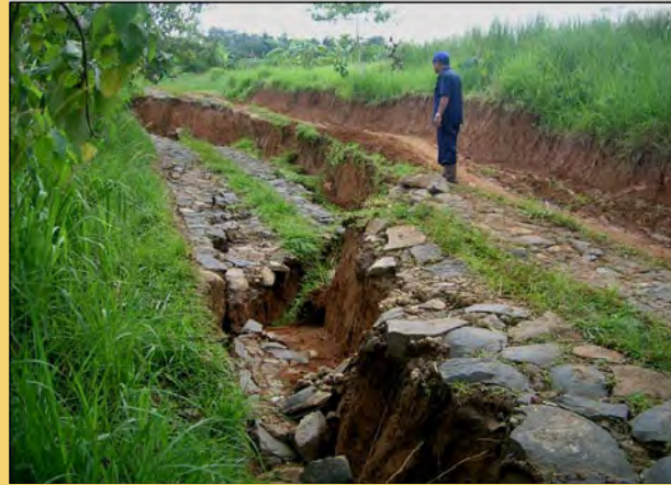
Gambar Retakan dan nendatan yang terjadi di bagian atas mahkota longsoran lebar rekahannya 20 – 40 cm, panjang retakan 35 m.
