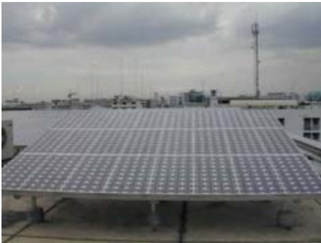
ระบบแผงเซลล์สุริยะขนาด 3 กิโลวัตต์บนดาดฟ้า สำนักงานนโยบายและแผนพลังงานในกรุงเทพฯ 3 kW grid-connect solar electricity at Energy Policy and Planning Office in Bangkok
