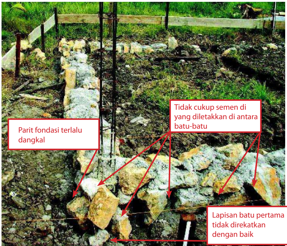
Lapisan batu tidak dilekatkan dengan campuran semen
