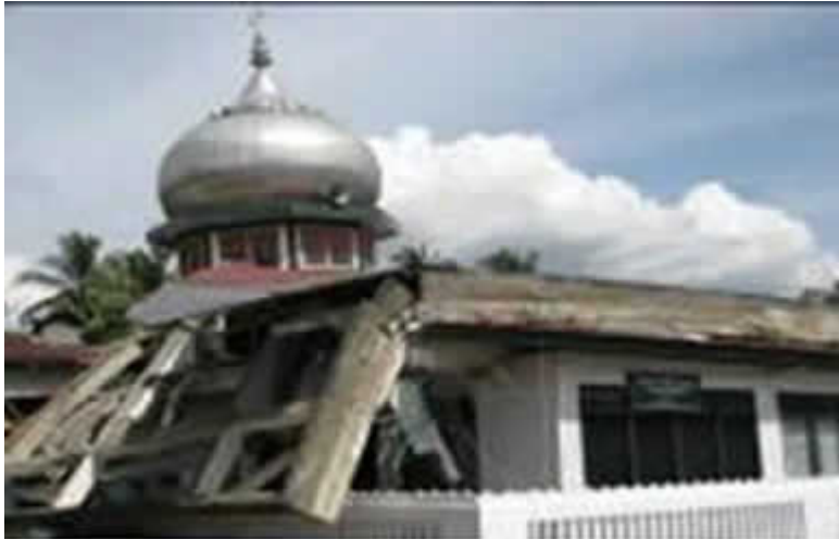
Gambar 2. 6 Kerusakan sarana ibadah di Sumani Kabupaten Solok
