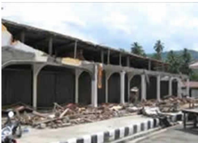
Gambar 2. 8 Kerusakan toko di Pasar Sumani, Kabupaten Solok
