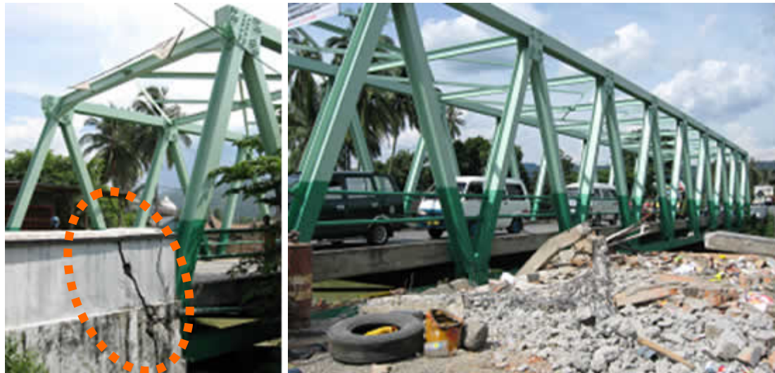
Gambar 2. 3 Kerusakan Jembatan di Sumani, Kabupaten Solok
