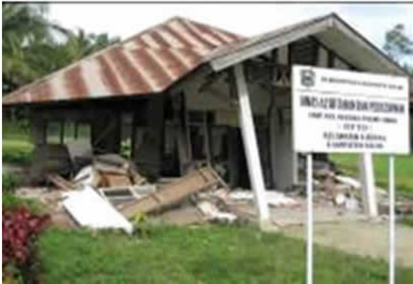
Gambar 2. 10 Kerusakan Kantor Dinas Kehutanan di Kab. Solok
