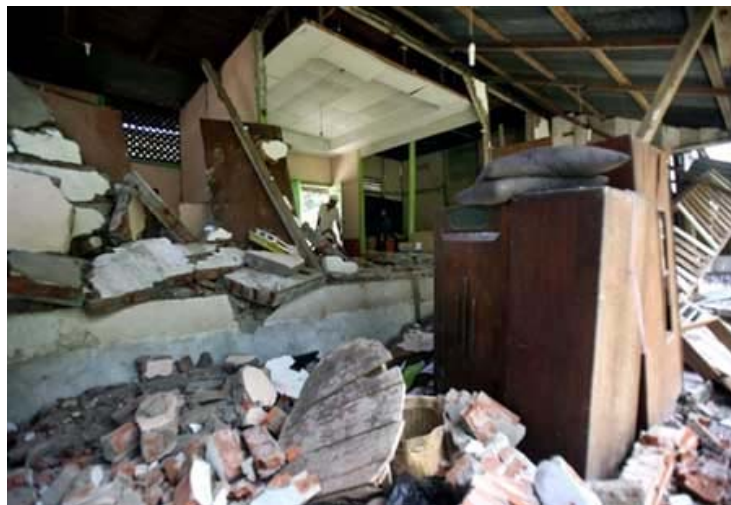
Gambar II. 12 Kerusakan Rumah di Provinsi Sumatera Barat
