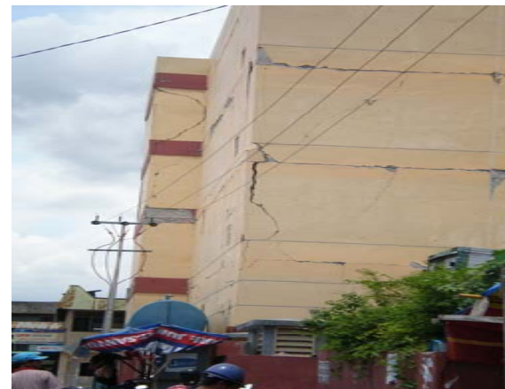
Gambar II. 16 Kerusakan Pada Bangunan Pertokoan
