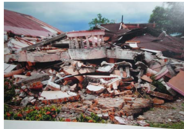
Gambar II. 5 Rumah Rusak Total
