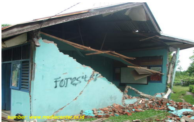
Gambar II. 6 Rumah Rusak Berat
