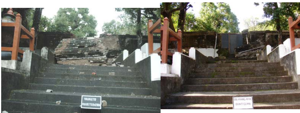
Gambar 3. 13: Kerusakan Gapura Paduraksa Kompleks Makam Imogiri (kiri) dan proses rekonstruksi (kanan)
