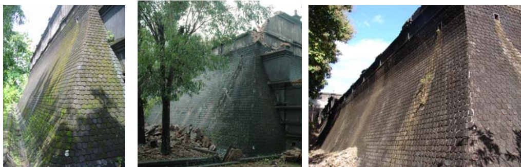
Gambar 3. 16: Benteng (pagar) terluar sisi barat dan utara Kompleks Makam Imogiri sebelum gempa (kiri), kerusakan akibat gempa (tengah) dan setelah rekonstruksi (kanan)
