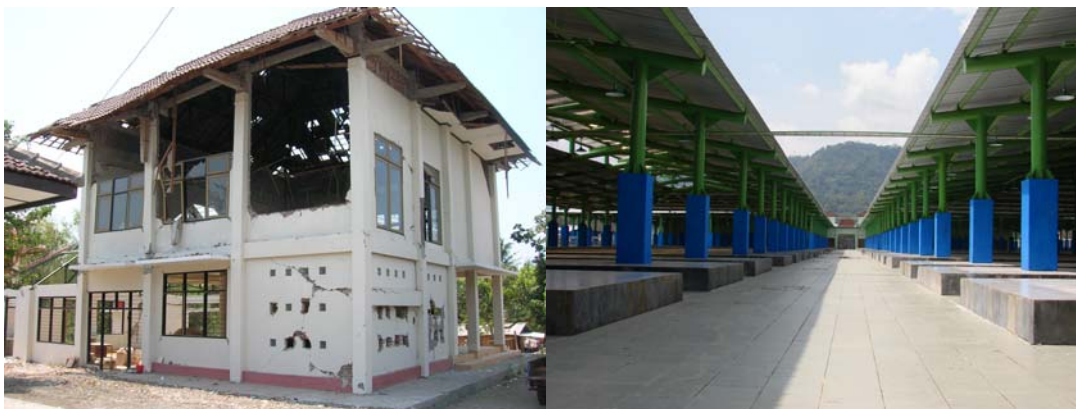
Gambar 3. 17: Bangunan UPT Kasongan yang rusak akibat gempa bumi (kiri) dan bangunan baru pasar Piyungan setelah rekonstruksi (kanan).
