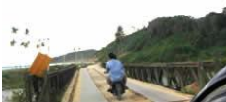
Belum diperbaiki (sementara), Aceh Jaya
