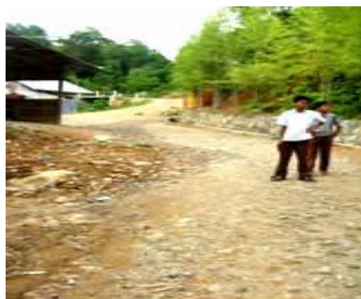
Gambar 3 - 12 Kondisi escape hill di Kabupaten Aceh Jaya yang belum selesai dibangun
