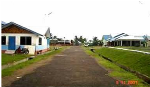
Gambar 3 - 17 Infrastruktur Jalan Sudah Mulai Rusak Pendaratan Pelelangan Ikan (PPI), Kec. Peudada, Kab. Bireun
