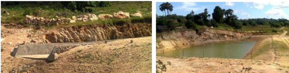
Gambar 1. Kondisi Erosi Embung Paska Pembangunan di Pulau Raijua
